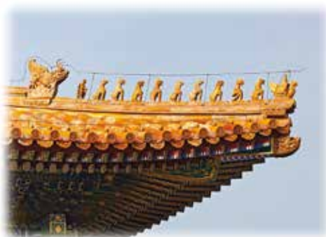
图1-34 古建筑上的避雷针
