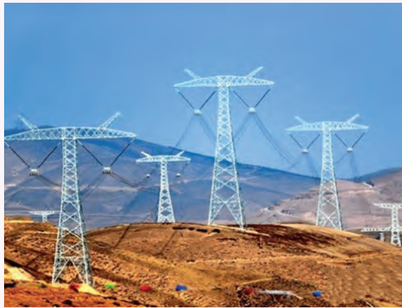
图 7-34 特高压直流输电线路
