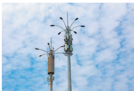
图 8-11 移动通信基站
