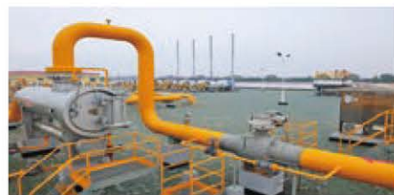
如东—海门—崇明岛管道海门站
