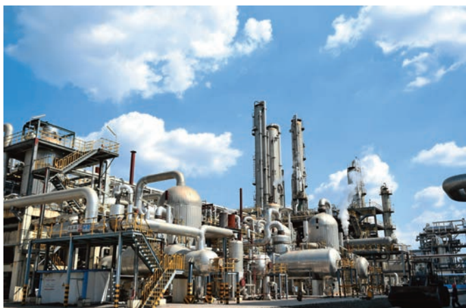
图 7.16 煤化工生产装置
