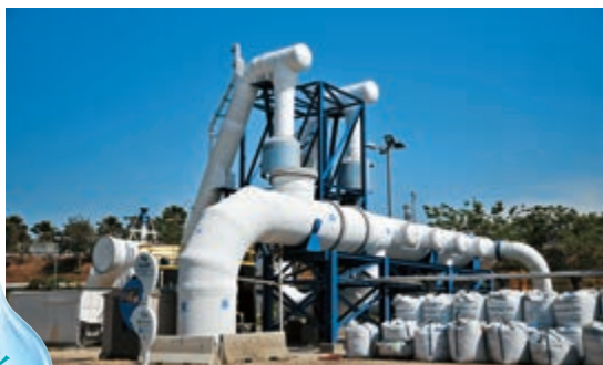
图3-72 海水淡化设施
